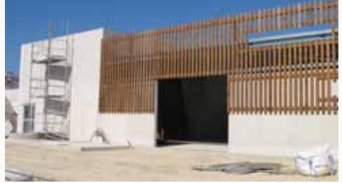
La station d'épuration à Condé : Bâtiment de traitement et de stockage des boues.
